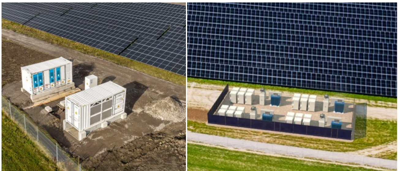
Figur 6. Batterilager, container-baserad lösning (vänster) och utomhusskåplösning (höger).
